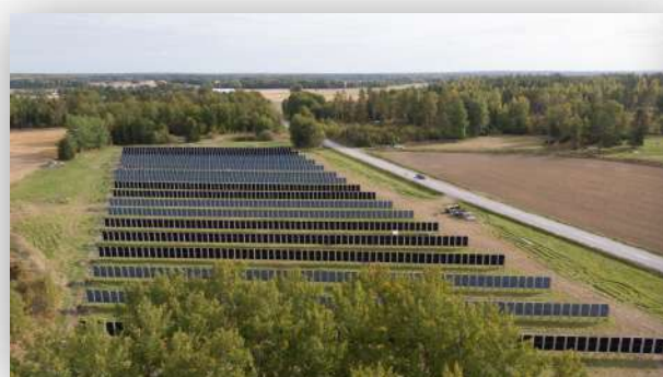
Foto/källa: Yiva Gjeträng – Linde energi
